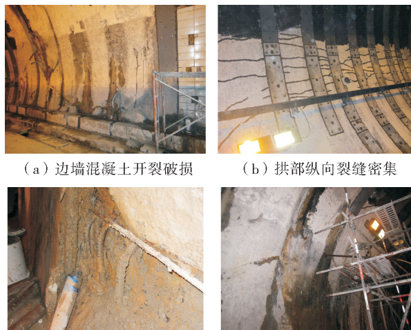
(a) 边墙混凝土开裂破损 (b) 拱部纵向裂缝密集 (c) 边墙内部钢筋锈蚀变形 (d) 打孔有股状的水喷射状流出
