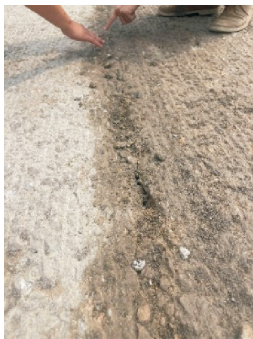
图 7 上基层顶面裂缝位置 水泥浆填充效果欠佳
