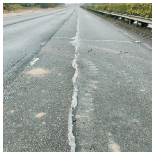
图1 路面纵缝病害
