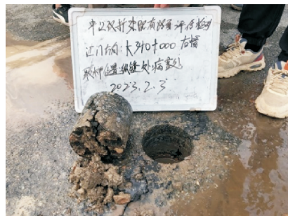
图2 典型纵缝处芯样,贯穿裂缝
