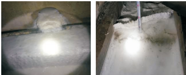
(b) 纵向排水管及排水沟结晶
