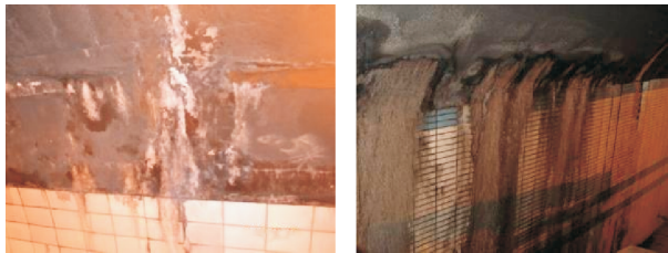
(a) 边墙表面及施工缝出现长斑
